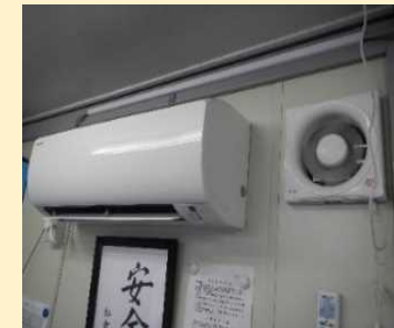
扇風機や換気扇とエアコンを併用
