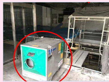
集塵機を設置し室内の換気を実施
