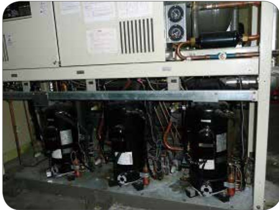
ユニット型冷凍機の異常振動確認
