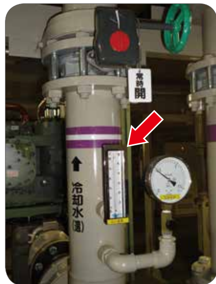
冷却水出口温度計確認
