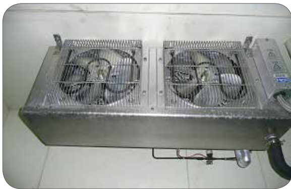
冷蔵庫内正常な冷却器外観
