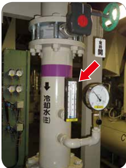
冷却水入口温度計確認
