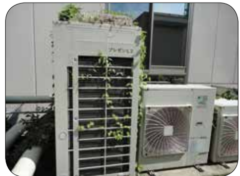
草で覆われた室外機
