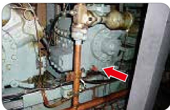
圧縮機周辺の油のにじみ状況
