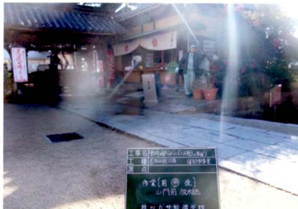
防災設備保守点検状況(浄土寺)
