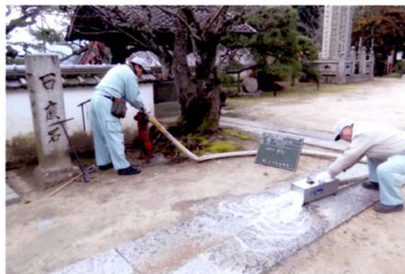
防災設備保守点検状況(西國寺)
