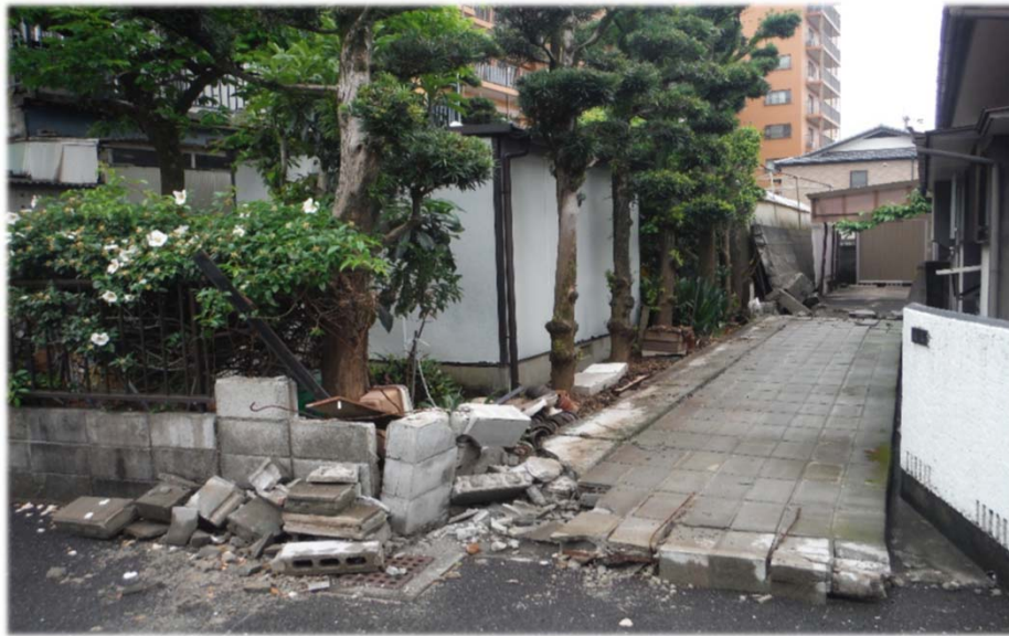
熊本地震で倒れたブロック塀（本市撮影）
