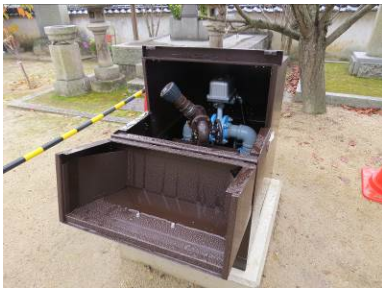
設置した放水銃
